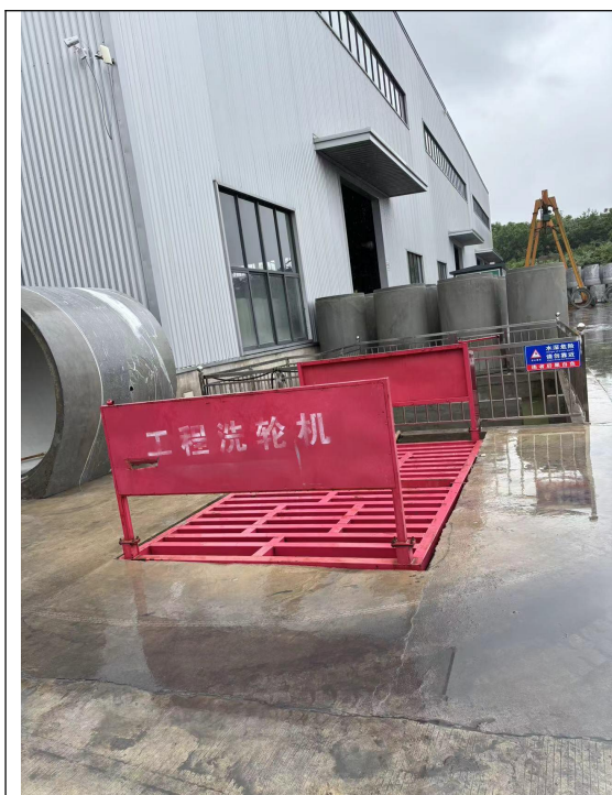
三级沉淀池及洗车平台
